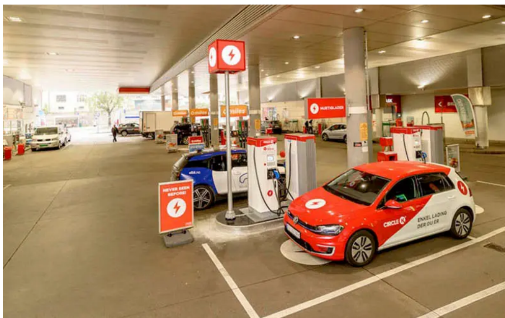
Fig. 2. Estación de servicio con recarga eléctrica.
