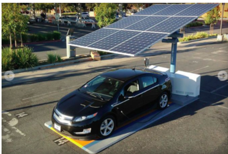
Fig. 1. Estación solar para recarga
